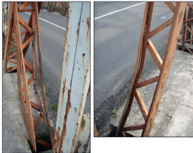
Figura 30 y 31. Rotura por impacto de cartela en margen derecho de vano nº3.
