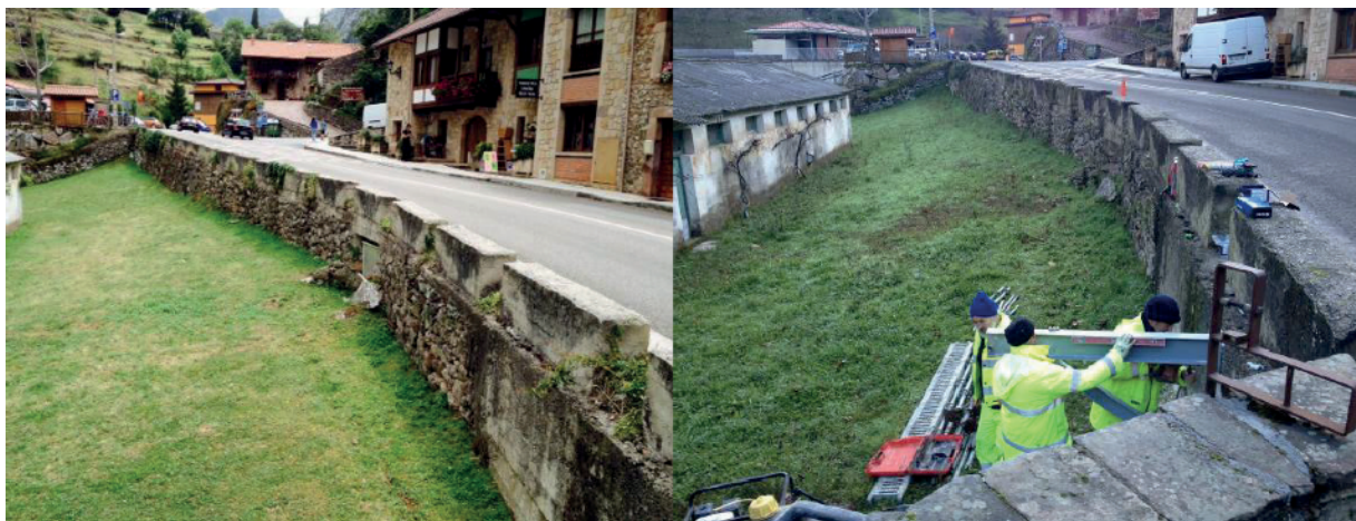
Figura 34. Carretera N-621, a su paso por la localidad de la Hermida, antes y
