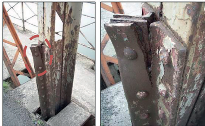
Figura 28 y 29. Rotura por impacto de cartela en margen derecho de vano nº3.
